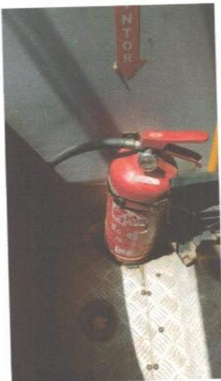
Extintor de Incêndio sem validade
