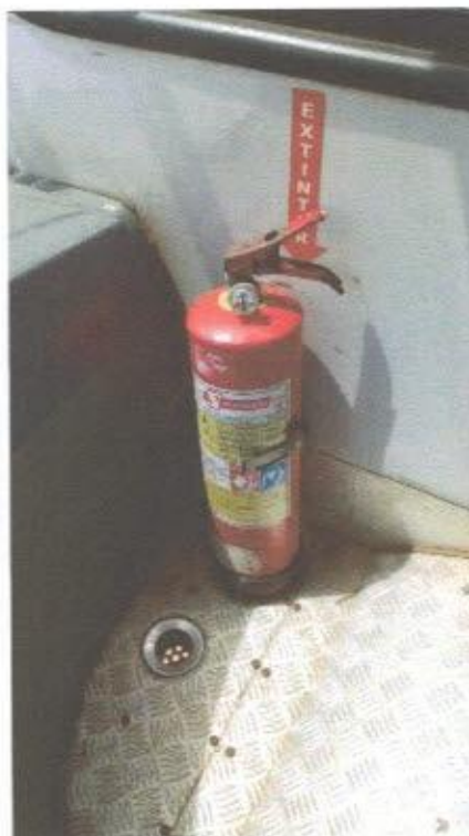
Extintor de Incêndio Vencido em 1º TRIMESTRE DE 2016
